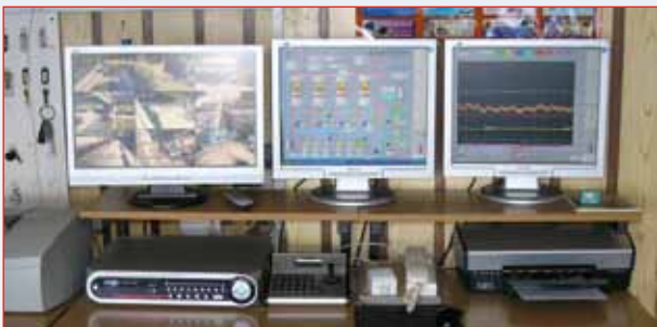
System nadrzędny - nadzór nad pracą Ciepłowni „Zasanie”
